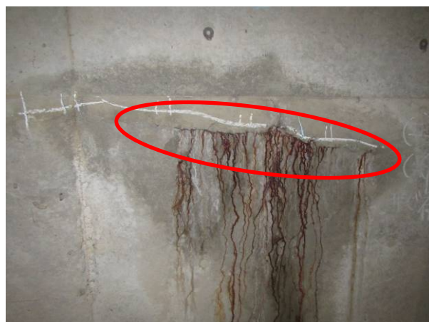
【コールドジョイント部からの漏水】
