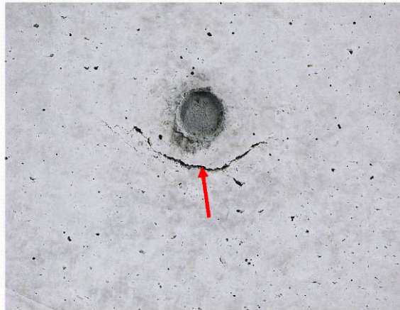
図 4.5.2 沈みひび割れ
