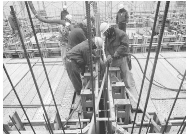
図-7 ポンプの筒先が奥深くに挿入できない状況
