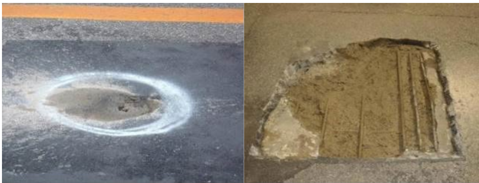
RC床版の土砂化の例（秋田県 国道7号）
